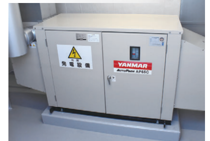
非常用発電設備
